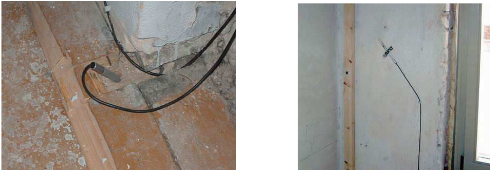
Bild 5 - Feuchtigkeits – und Temperaturmeßfühler im Mauerwerk und im Balken (Eigene Photos)
